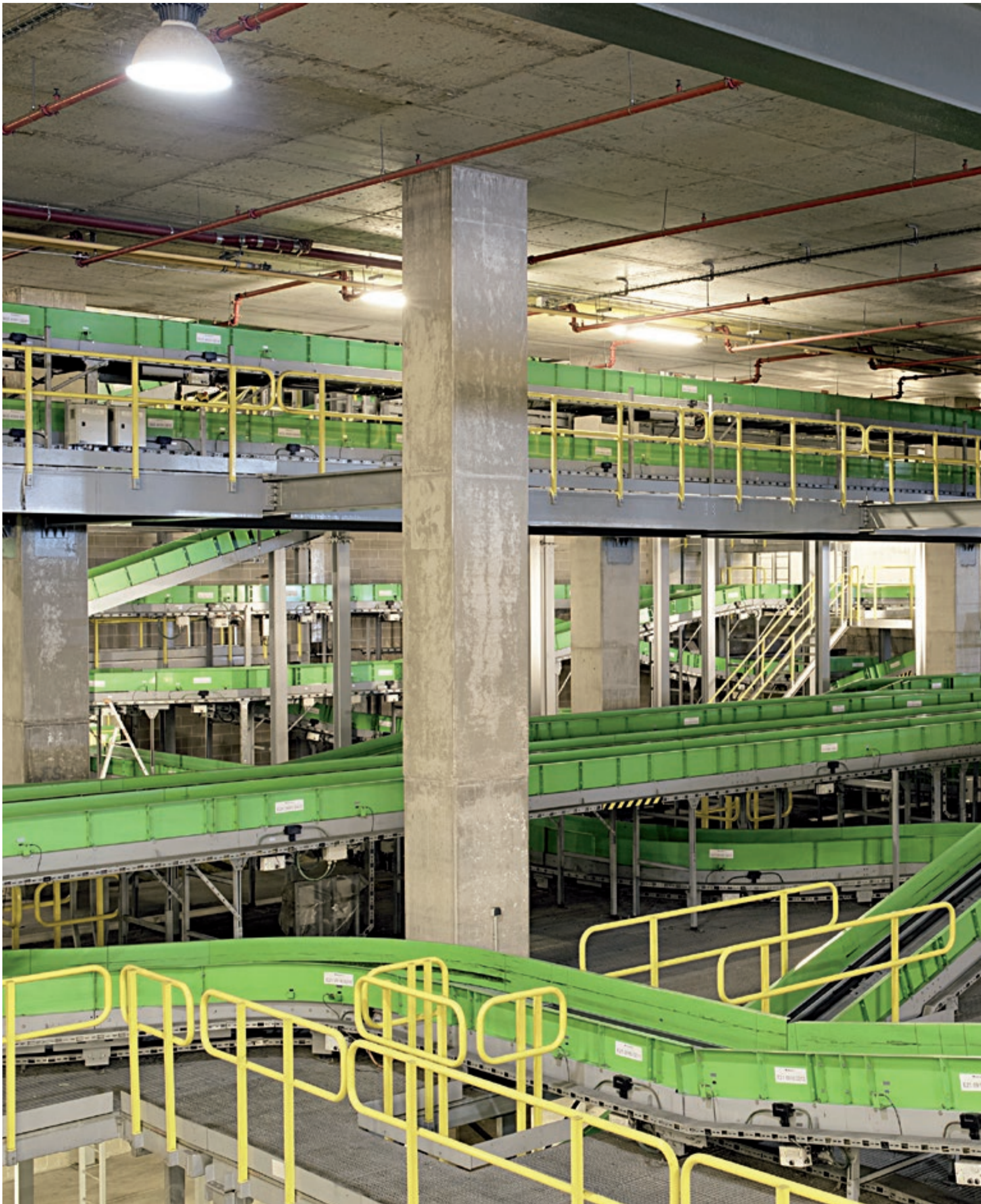
Aeroport del Prat. Sistema d'Automatització de Tractament d'Equipatge (SATE).
